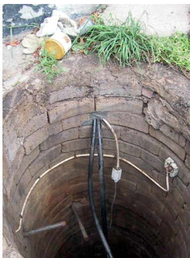
Figur 4-4 Eksempel på uacceptabel brøndkonstruktion
