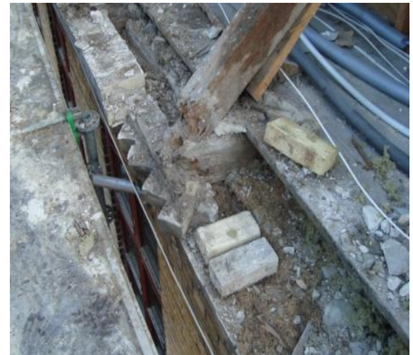
Foto af råd og svamp i tagkonstruktionen
