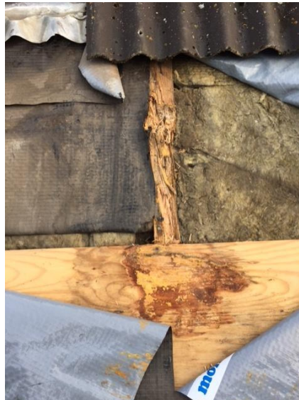
Foto af fugtskader i gamle eternitplader
