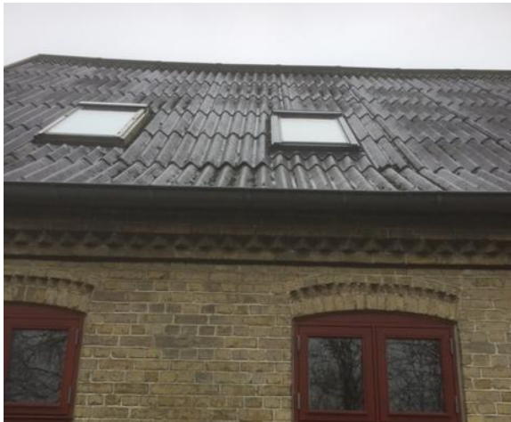
Foto af sunket tag på Bredekærgård
