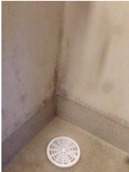
Foto af fugt- og svampeskader
