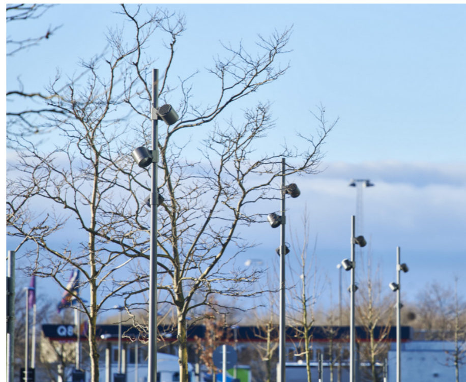
Mastearmaturer med spotlys placeret inde i beplantningen.
