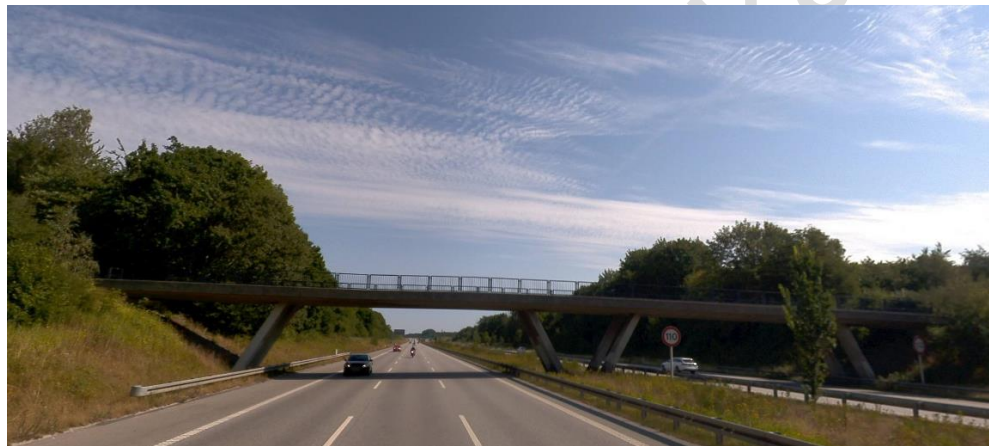
Figur 13 Stibroen ved Tjørnevej set mod nordøst, hvor broens understøtninger optager størstedelen af midterrabbatten. DDG © COWI.
