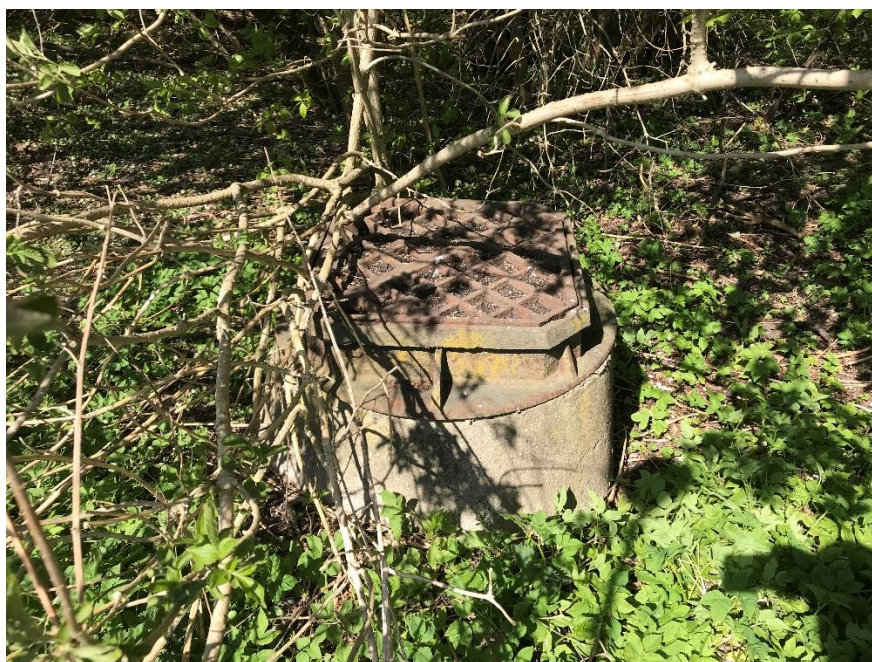
Figur 3.9: Et eksempel på en af de brønde der er på den gamle ledning. Foto: NIRAS 2019-04-23.
