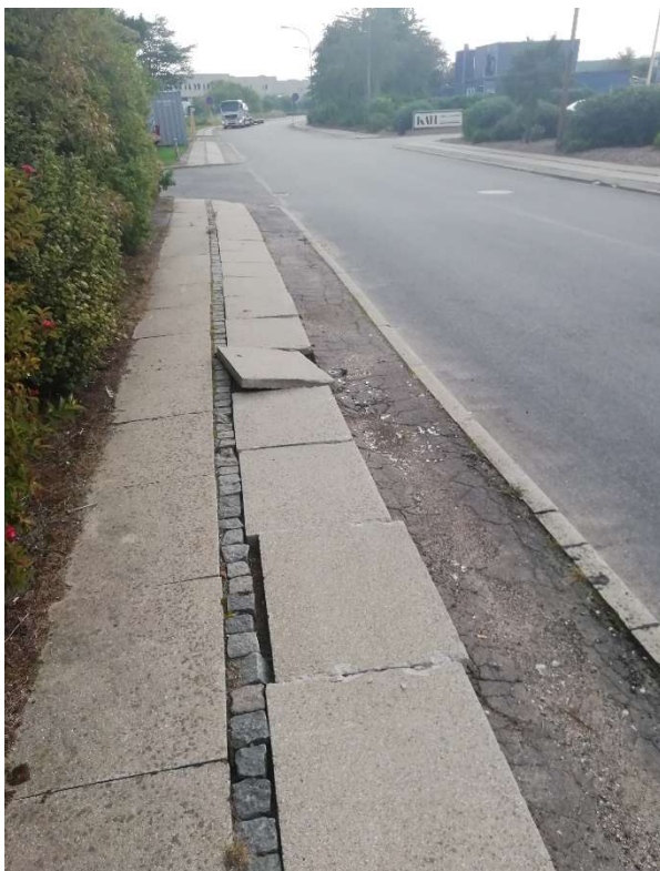
Figur 3.4 – Billede 5.9 Løse fliser med farlige opspring ud for Industri Kroen nr. 1.
