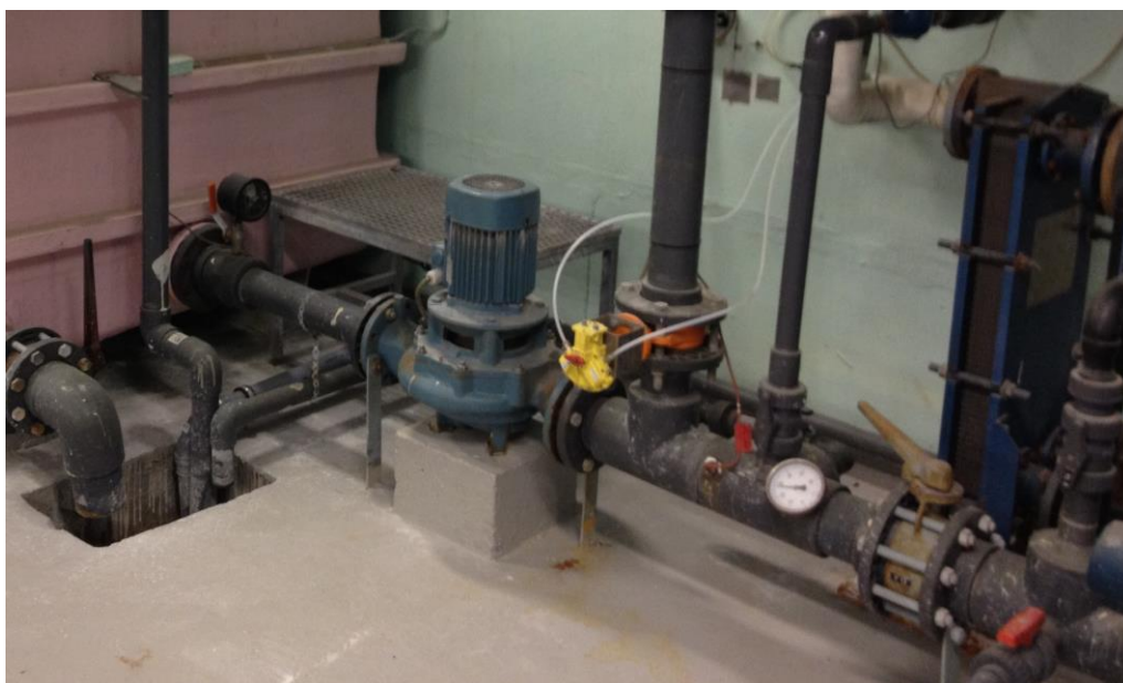
Foto 5 Delvis nedslidt cirkulationspumpe og slidte ventiler ved anlæg for børnebassin.
