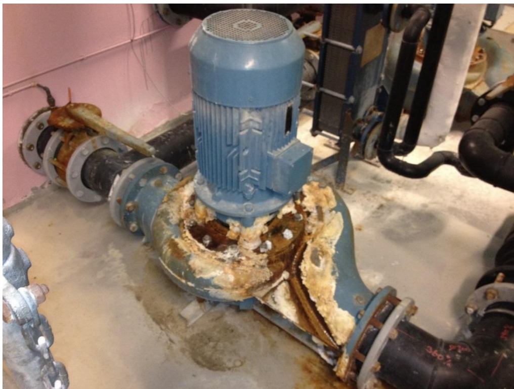
Foto 4 Nedslidt cirkulationspumpe til svømme- og springbassin.
