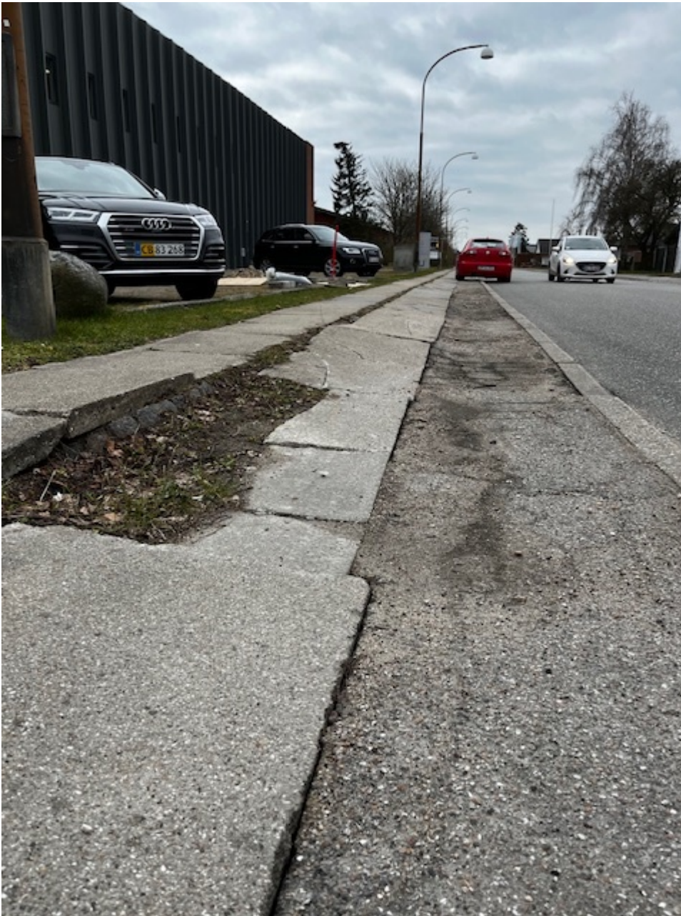
Billede 1: Billedet viser den nuværende tilstand af fortovene i industri kvarteret, som står over for reovering
