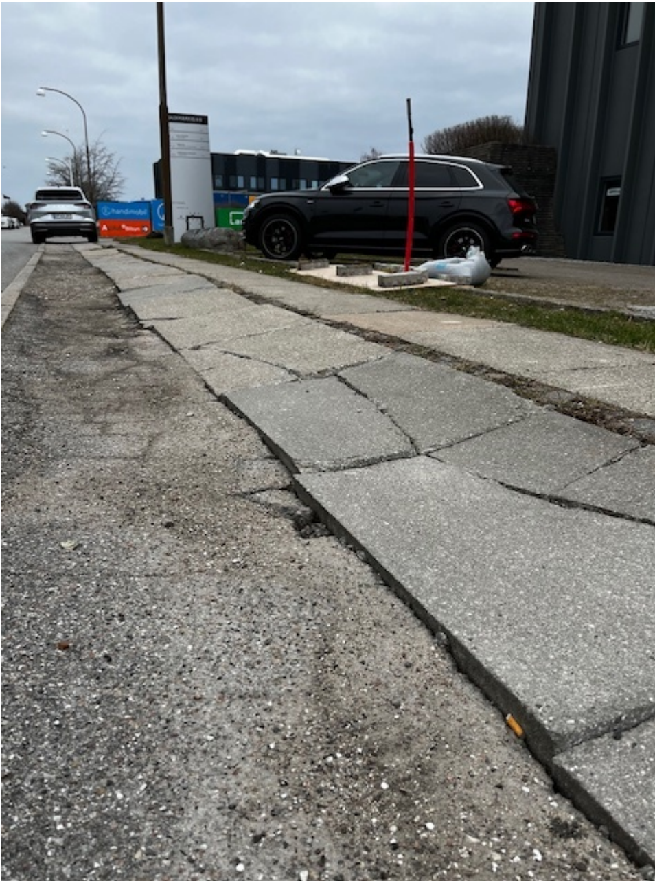
Billede 2: Billedet viser den nuværende tilstand af fortovene i industrikvarteret, som står over for renovering
