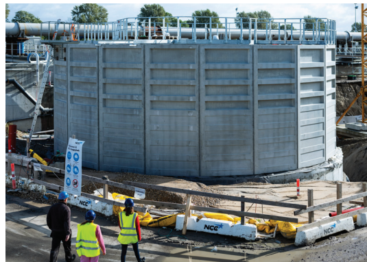
Renseanlæg Damhusåen fordelerbygværket.
