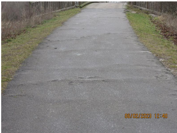
Figur 1 Typisk skadebillede hvor rødder har ødelagt stibelægningen
