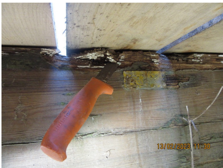
Figur 6 Grønnebro. Rådskade i oversiden af bærende limtræsbjælke lige under dækplankerne
