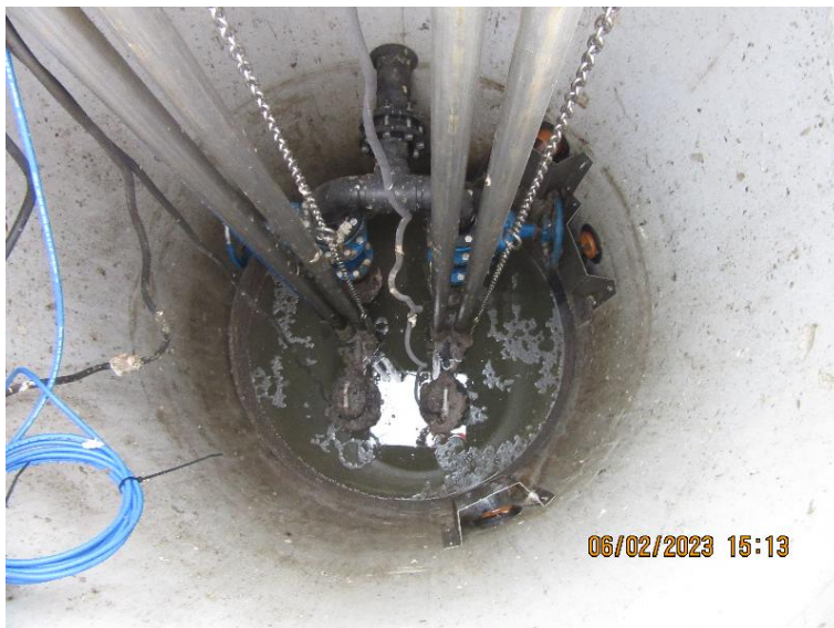
Figur 7 Foto ned i brønd. Selve pumpen er neddykket
