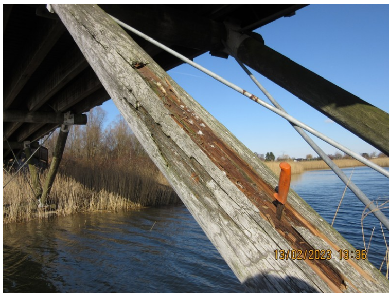
Figur 4 Jægerbro. Svær rådskade i et af de bærende skrån
