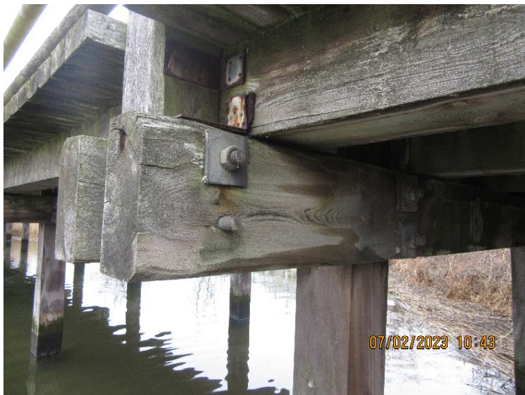
Figur 2 Fiskebroen, en af de lave broer. Rustne beslag og manglende møtrik. Nogle pæle lider af begrænsede rådangreb omkring vandlinjen.
