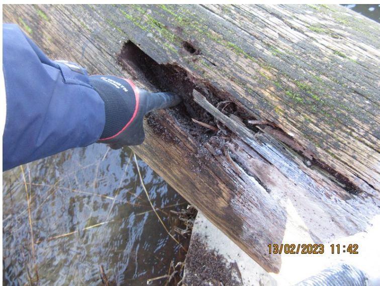
Figur 5 Grønnebro, dyb rådskade i nedre tværdrager
