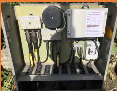
Ovenstående figur viser et forstærkerskab efter opgraderingen.
