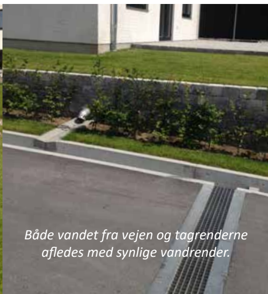
LAR-løsning (lokal afledning af regnvand) ved Kirkebjerggårdsvej i form af vandrender som løber ned i et regnvandsbassin.
