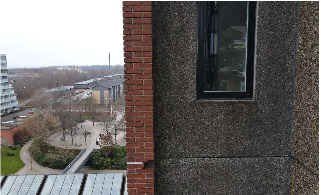
Knækket sten og store huller i fugerne
