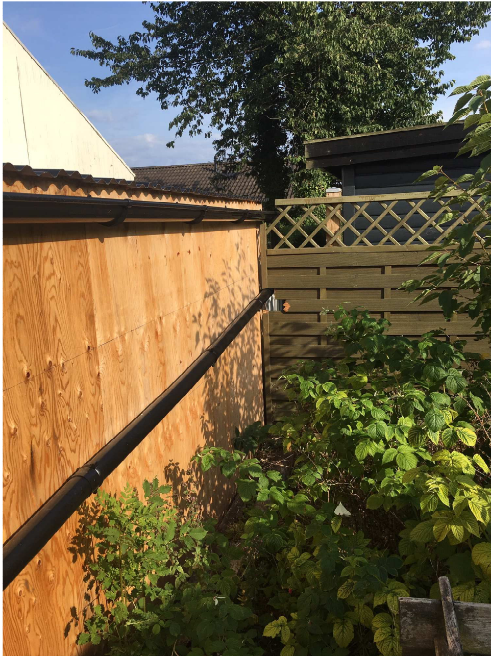
Bagvæg af skur set fra Ørnekærs Vænge 12, tagrende og gennembrydning af fælleshegn mellem Ørnekærs Vænge 10 og 12.
