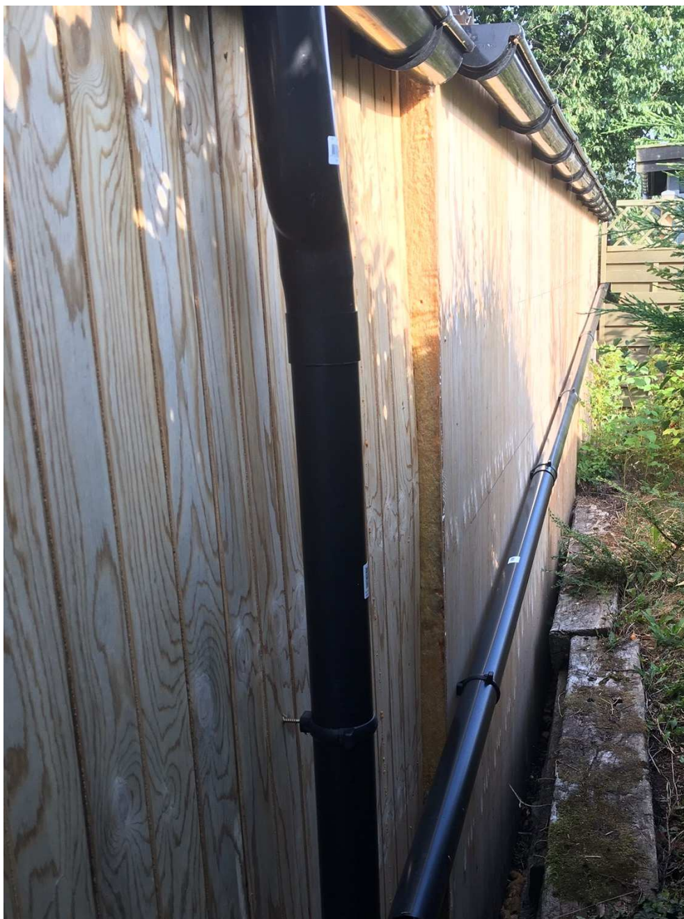
Skur 1 (bagvæg i profilplade) og skur 2 (bagvæg i x-finér) – viser tagrenderne til begge og afløbsrør.
