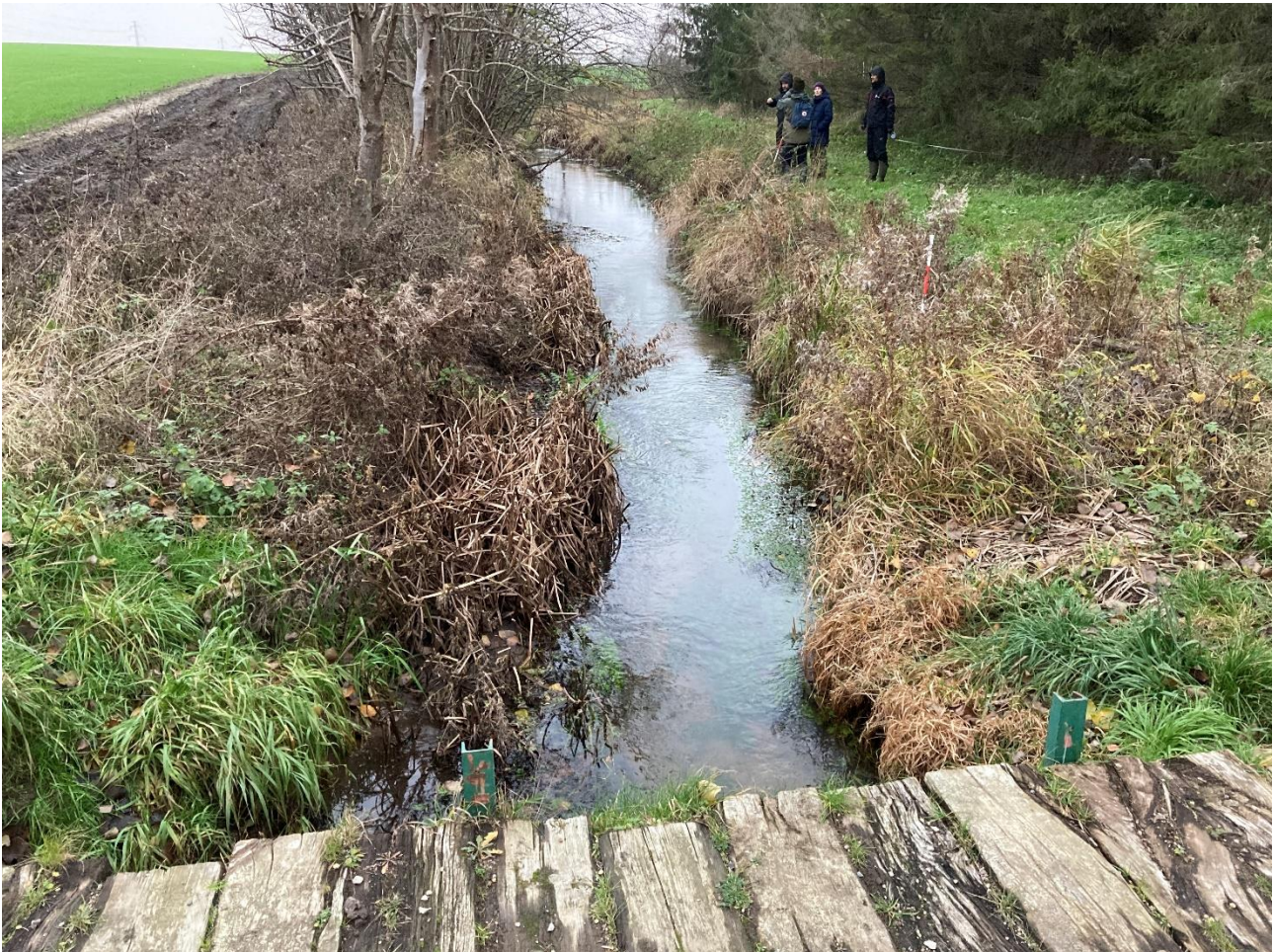
Figur 4.13: St. 6.752 opstrøms. Der er mange steder som her på venstre side i fotoet dannet brinkfodder ved skæring af en strømrende, i det tidligere meget brede regulerede profil. NIRAS december 2020.
