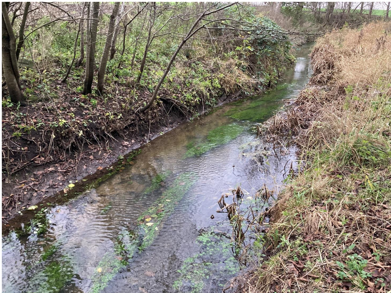
Figur 4.14: St. 6.730 opstrøms. På beskyttede strækninger eller hvor vandløbet ligger dybt under terræn, er det tidligere meget brede profil tydeligt, og der sker erosion af brinker. Bunden består af sand, og der er en ringe fysisk variation. NIRAS december 2020.
