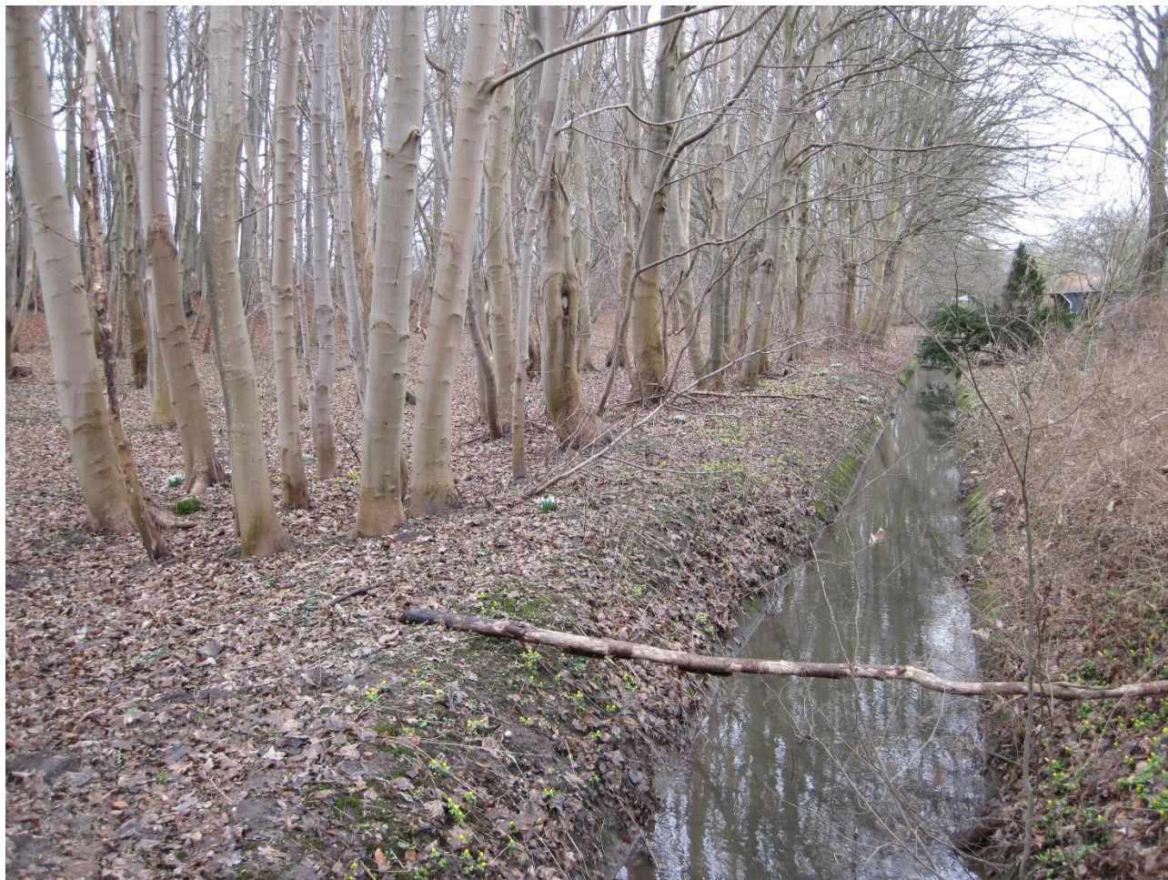
Figur 4.9: Den fliselagte strækning omkring st.3.950 opstrøms. NIRAS Marts 2021.
