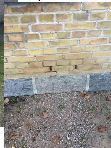
Foto af forvitrede fuger, Ishøj Gård
