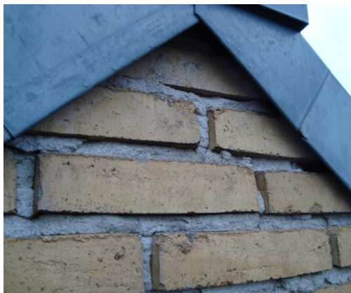
Foto af forvitrede fuger, Kærbo
