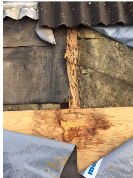
Foto af fugtskader i gamle eternitplader
