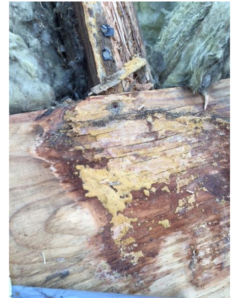
Foto af råd og svamp i spær og spærfod
