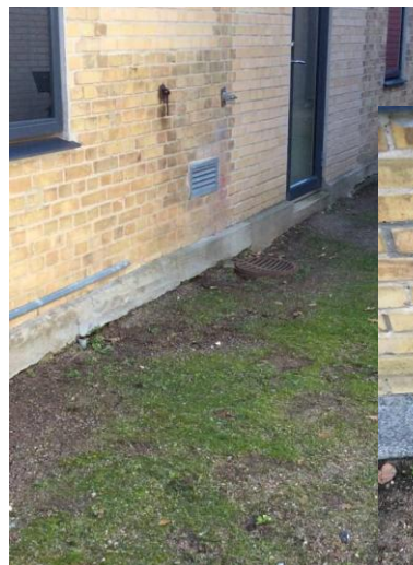
Foto af afskallet sokkel, Ishøj Gård
