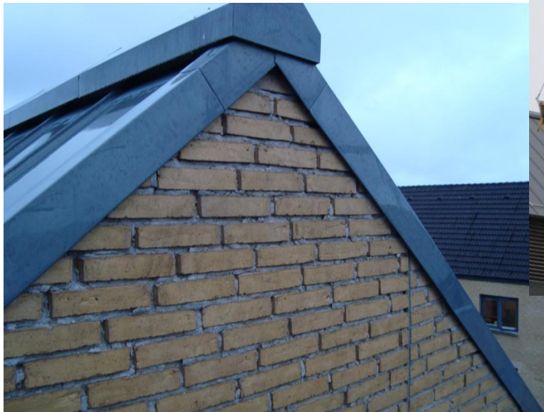
Foto af fuger, der er forvitret
