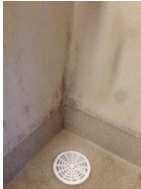
Foto af fugt- og svampeskader
