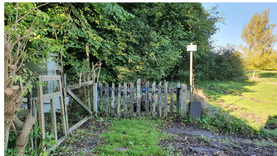
Øv. tv. Klippet græs ved kildeplads C. Øv. th. Cementkant langs sti på Thorsbro vandværk. Nederst: Sidste rest af det stakit ved Solhøj kildeplads, som har omkranset hele kildepladsen og blev tjæret hver år, samt et gammelt skilt med 'adgang forbudt'. Tilsvarende eller en klippet hæk har stået omkring Thorsbro vandværk og de øvrige kildepladser.
