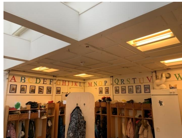
Foto af eksisterende lysarmaturer i Troldebo
