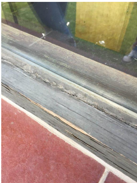
9 Før - foto af vinduesramme på Vibeholmskolen
