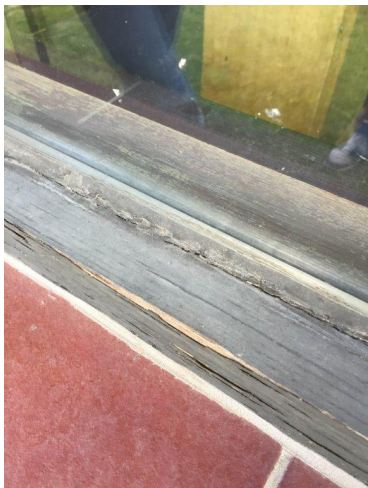
Foto af rådnen vinduesramme på Vibeholmskolen.
