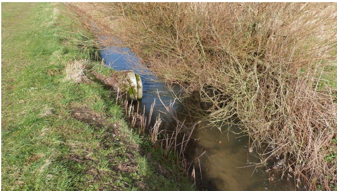
Figur 10: Rørtilførsel ø80 i st. 968 i HTK-regulativ set opstrøms. Bemærk sandaflejringerne og den manglende skyggegivende vegetation på vandløbets sydvestside dvs. til venstre i billedet
