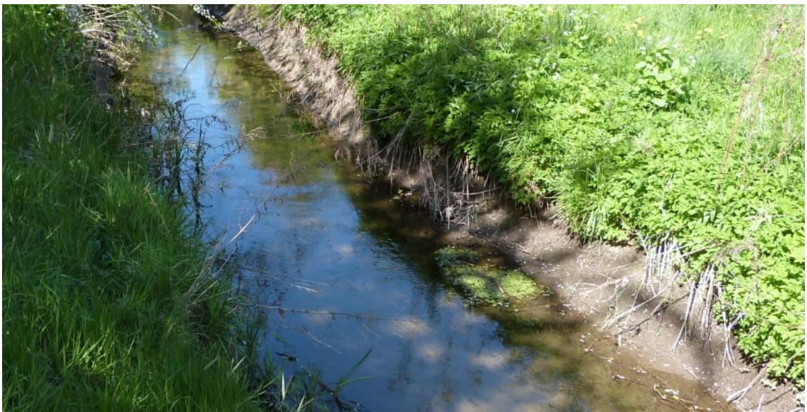
Figur 24: Hårdt vedligeholdt strækning ca. st. 4300 (SWECO 9370).
