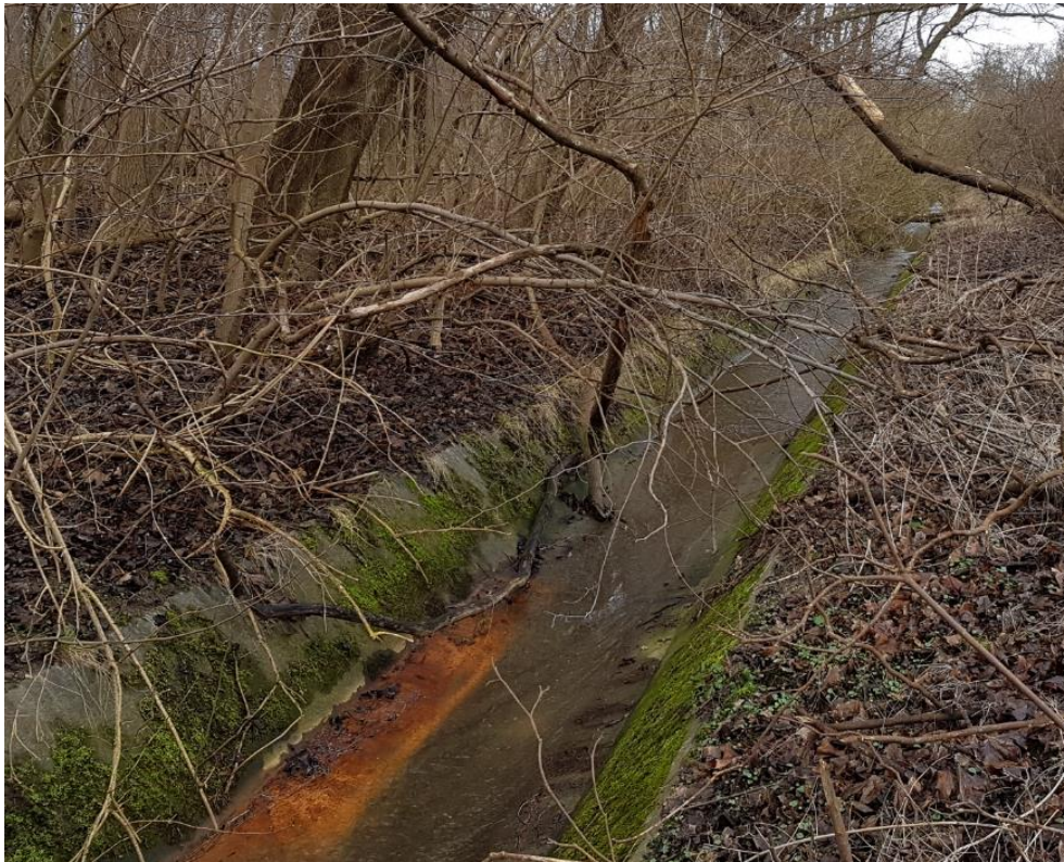
Figur 19: Flisebelagt bund med stort fald ved Torslunde vandværk
