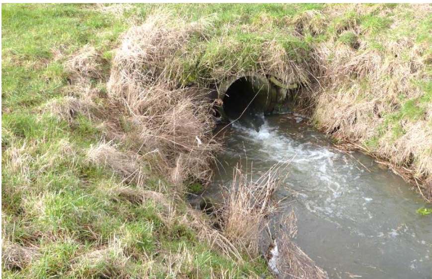
Figur 13: Røroverkørsel med fald ved udløb. Der er meget vand i vandløbet og ved lavere vandføringer vil spærringen være større
